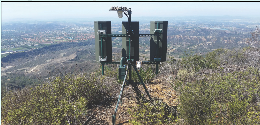
Instalación de 3 nodos AE6XE en el condado de Orange California
